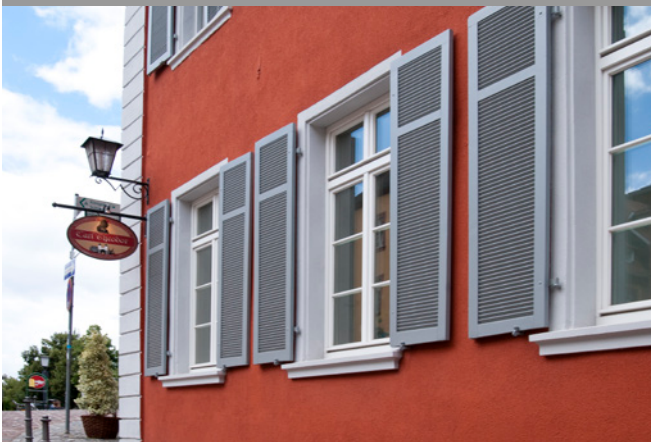
Historische Kalkputze oder hydraulische Putze
